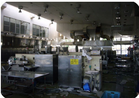
大規模な被害を受けた第2学校給食センター
